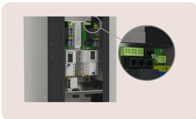
Image 17: Vue sur le port A+B du tableau relais
