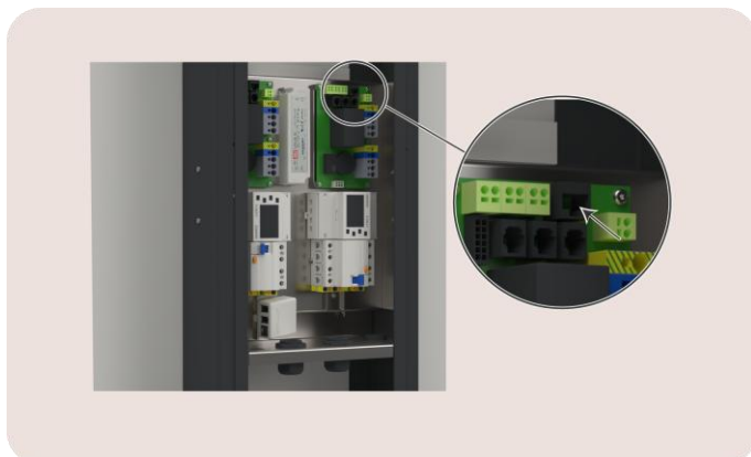
Image 12: Vue sur le port A+B du tableau relais
