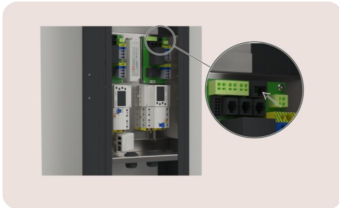
Abbildung 12: Ansicht der A+B-Anschlüsse der Relaisplatine
