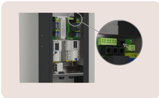
Abbildung 12: Ansicht der A+B-Anschlüsse der Relaisplatine
