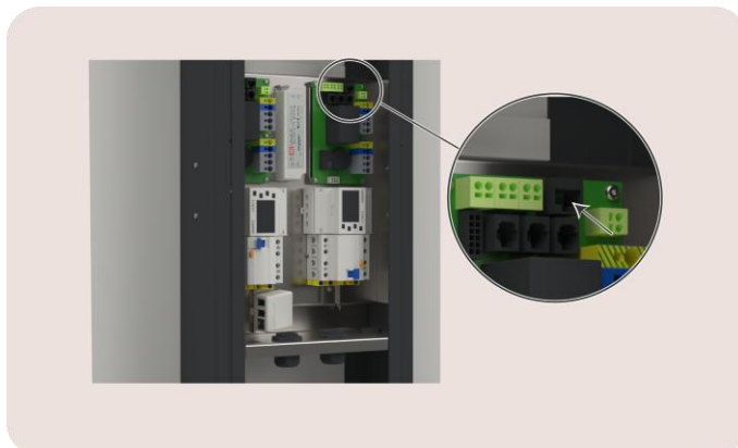
Abbildung 17: Ansicht der A+B-Anschlüsse der Relaisplatine
