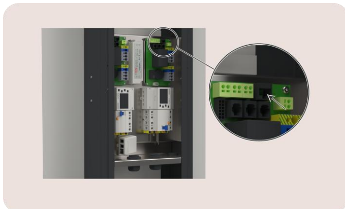
Abbildung 17: Ansicht der A+B-Anschlüsse der Relaisplatine
