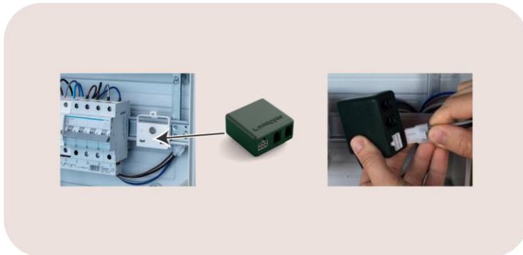
Abbildung 4: Blick auf eine Verteilertafel mit Halter für DIN-Montageplatte und Power Box
