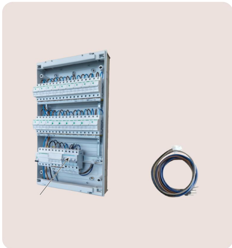
Abbildung3: Blick auf eine Verteilertafel und das Stromversorgungskabel
