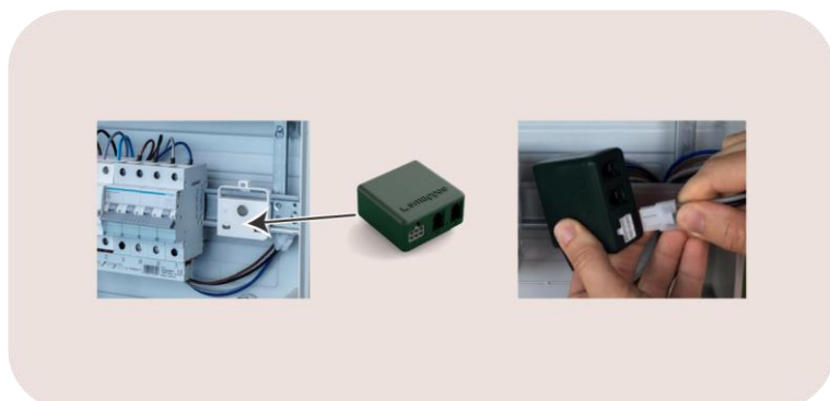
Image 4 : Vue d'un panneau de distribution avec plaque de fixation DIN et Power Box
